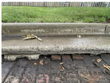
Edge Before Repair
